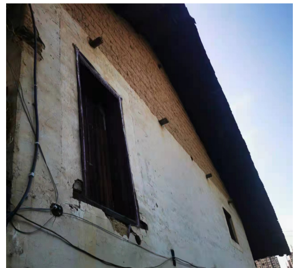
建房六十载已成危房存安全隐患。
