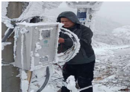
图为中国铁塔工作人员接线发电。
